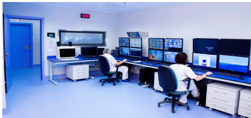
PUESTO CENTRAL DE CONTROL DE LA UAAN
