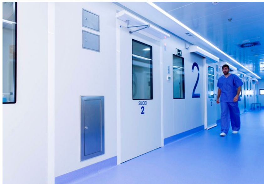
PUERTAS DE ACCESO A LAS HABITACIONES. REGISTRO DE INSTALACIONES DESDE PASILLO.
