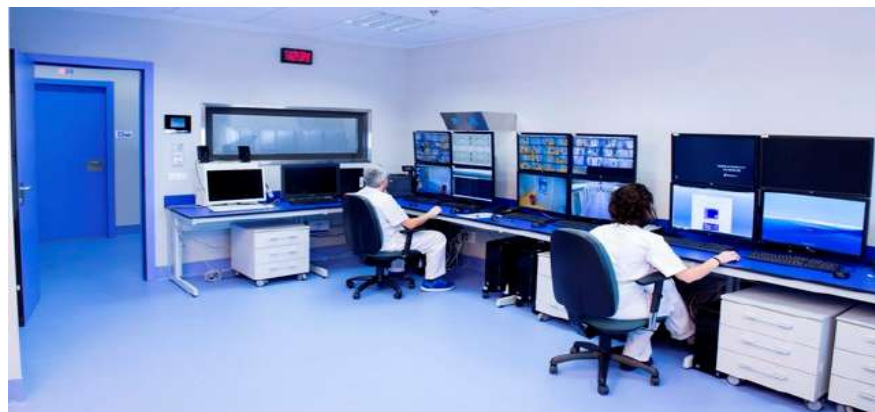
PUESTO CENTRAL DE CONTROL DE LA UAAN
