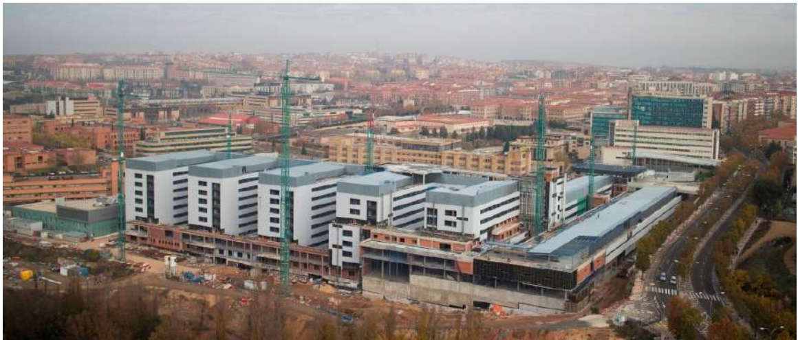
ESTADO ACTUAL DE LAS OBRAS ACCESO A LAS URGENCIAS Y VISTA DE LOS NUCLES DE HOSPITALIZACION
